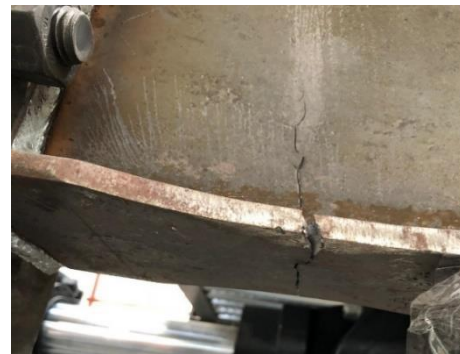
δ) Αστοχία στο κέντρο της RBS 1C
