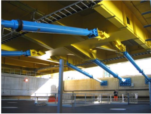
Σχήμα 2.1 – Ιξώδεις αποσβεστήρες εφαρμοσμένοι στη Γέφυρα Ρίου-Αντιρρίου (Ελλάδα) - (πηγή: FIPMEC srl)
