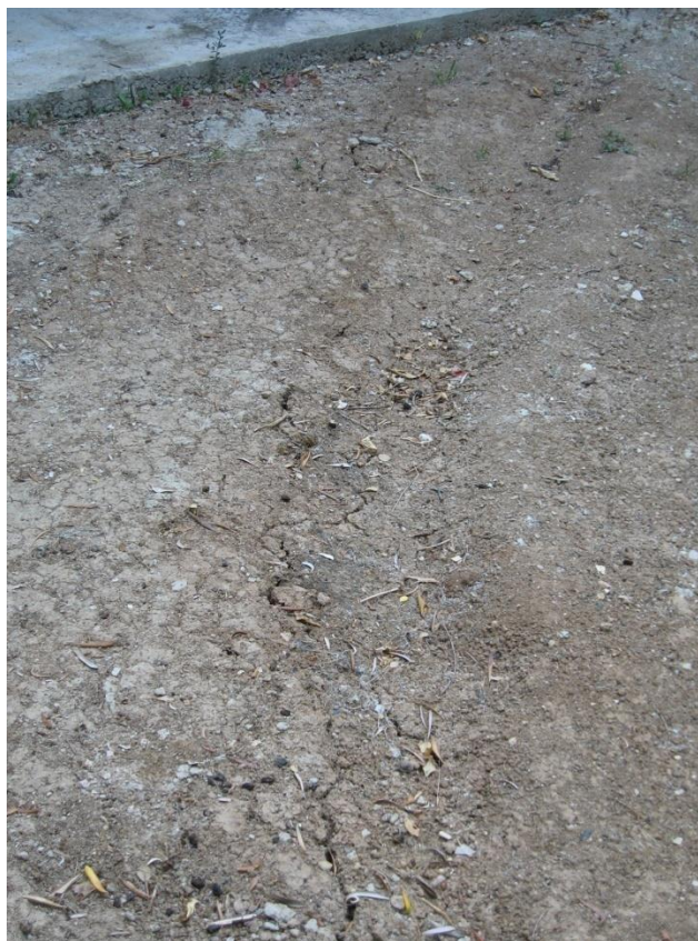
Εικόνα 4.9 : Ρωγμή στην αυλή της κατοικίας μετά τη δεύτερη αστοχία
