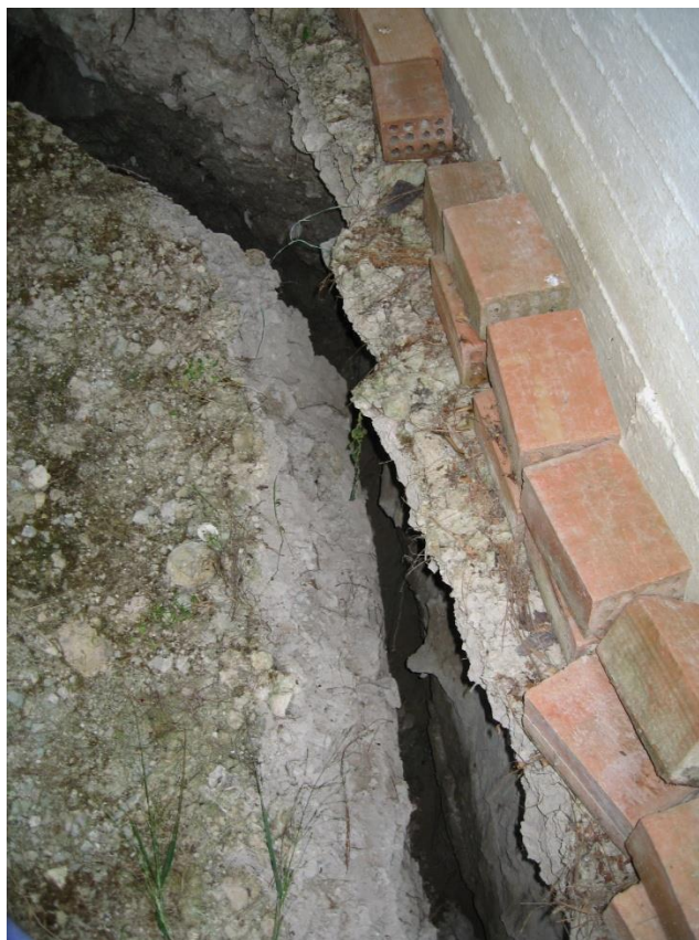
Εικόνα 4.7 : Ρωγμή στην αυλή της κατοικίας μετά τη δεύτερη αστοχία
