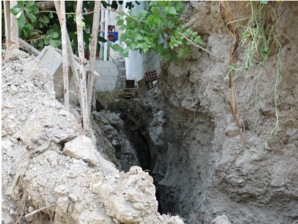
Εικόνα 4.6 : Ρωγμή στην αυλή της κατοικίας μετά τη δεύτερη αστοχία
