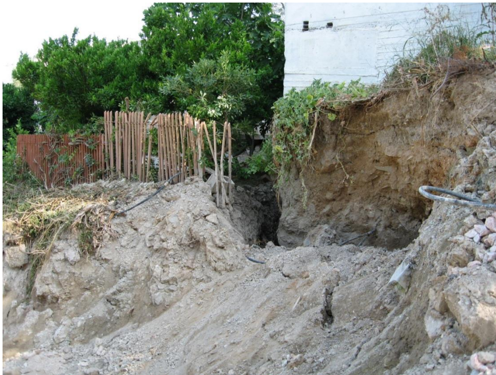
Εικόνα 4.4 : Η αυλή της κατοικίας μετά τη δεύτερη αστοχία
