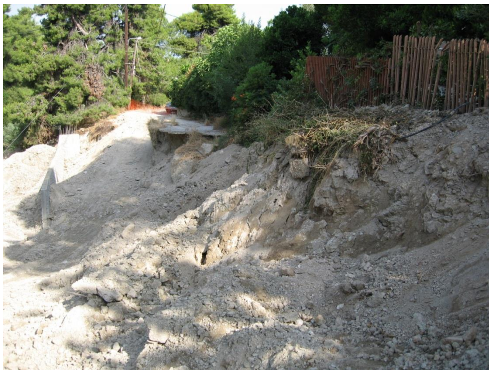
Εικόνα 4.5 : Τμήμα του δρόμος μετά τη δεύτερη αστοχία. Διακρίνεται και ο υπό κατασκευή τοίχος αντιστήριξης στη βάση του πρανούς.
