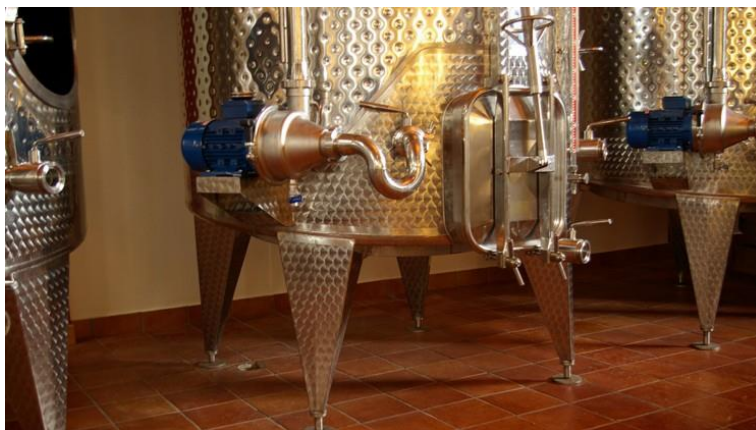
Εικόνα 7: Δεξαμενή ερυθρής οινοποίησης με ενσωματωμένο σύστημα ανακύκλωσης του γλεύκους
