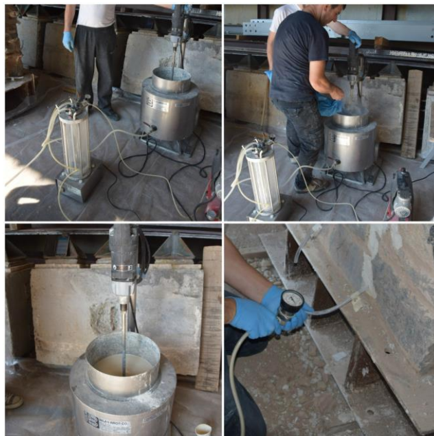
Εικόνα 49. Φωτογραφίες του εξοπλισμού ανάδευσης με υπερήχους κι εφαρμογής των ενεμάτων στους τοιχίσκους
