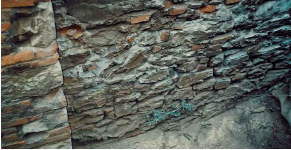
Εικόνα 11. Χαρακτηριστικό παράδειγμα διάβρωσης της βάσης λιθοδομής
