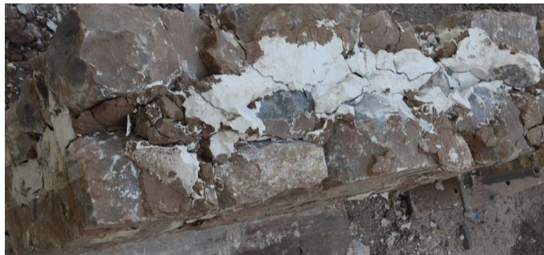
Εικόνα 109. Συγκέντρωση μεγάλης ποσότητας ενέματος στο κέντρο της του τοιχίσκου Π1
