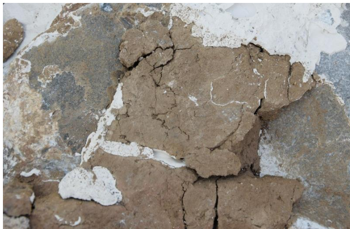
Εικόνα 110. Τυπικά παραδείγματα ρωγμών μικρότερου πλάτους στον τοιχίσκο Π1
