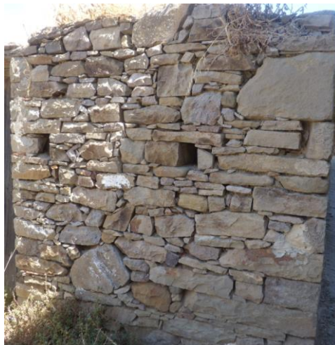
Εικόνα 5. Χαρακτηριστικό παράδειγμα παθολογίας σε λιθοδομές με πηλοκονίαμα στην Λήμνο (αποσάθρωση κονιάματος καθώς και ανάπτυξη φυτών)
