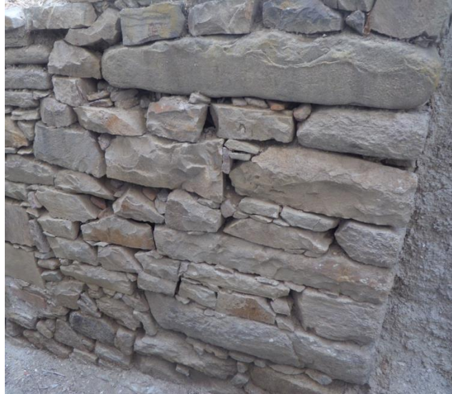
Εικόνα 12. Χαρακτηριστικό παράδειγμα αποσάθρωσης πηλοκονιάματος
