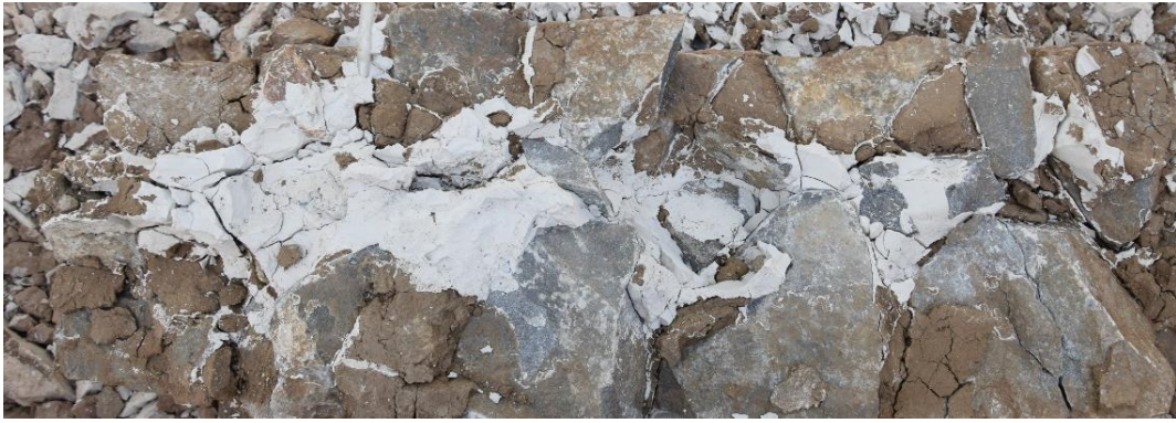
Εικόνα 111. Δίκτυο ενέματος στον τοιχίσκο Π1
