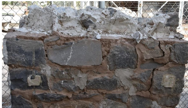
Εικόνα 115. Ρηγμάτωση ενέματος στον τοιχίσκο ΑΠ1
