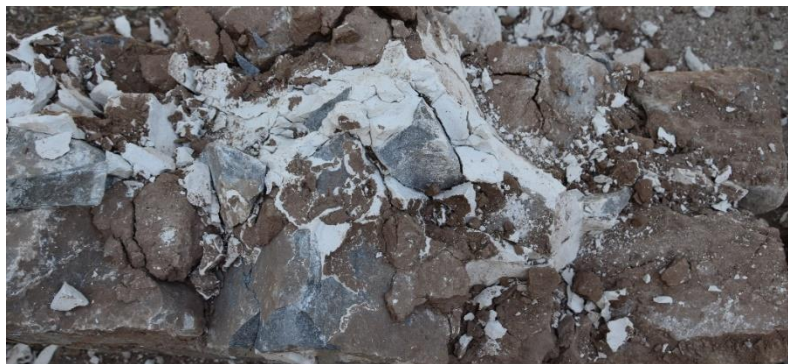
Εικόνα 108. Τυπικό πλάτος ρωγμών που πλήρωσαν τα ενέματα στον τοιχίσκο Π1
