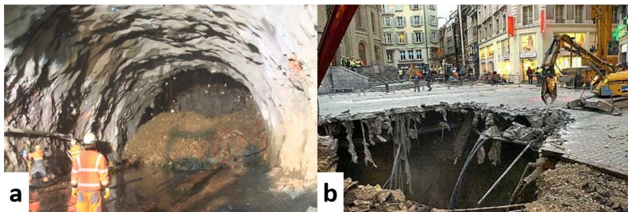
Εικόνα 6. 1. Αστοχία μετώπου εκσκαφής α) σε βαθιά σήραγγα β) σε ρηχή σήραγγα με πρόκληση επιφανειακών βλαβών (Πηγή: SkyscraperCity).
