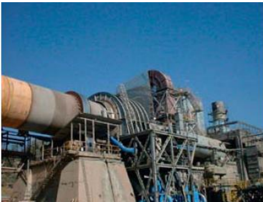
Εικόνα 5.3 Ψύκτης τύπου έσχαρας εργοστασίου Καμαρίου [39]
