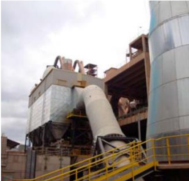
Εικόνα 5.5 Σακόφιλτρο του ενός περιστρεφόμενου κλιβάνου του εργοστασίου Καμαρίου [39]
