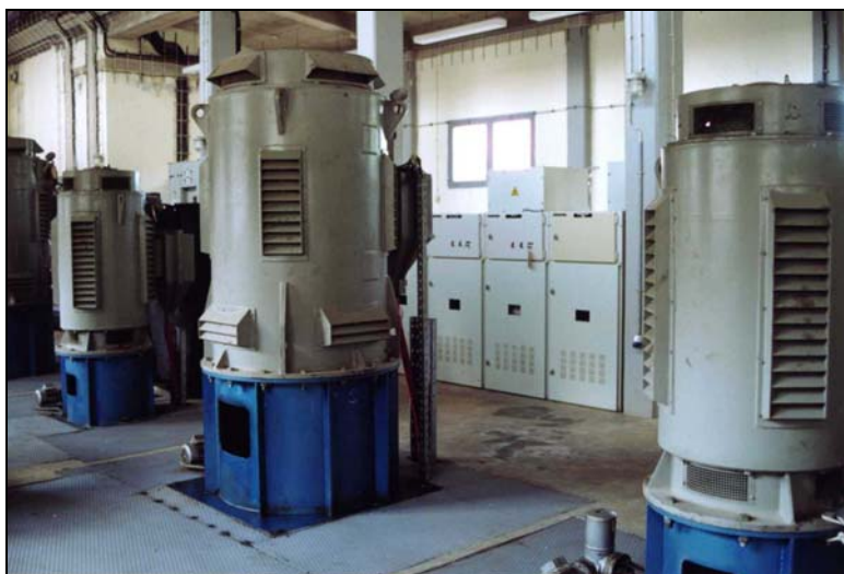
Εικόνα 11: Άποψη του εσωτερικού των εγκαταστάσεων του αντλιοστασίου
