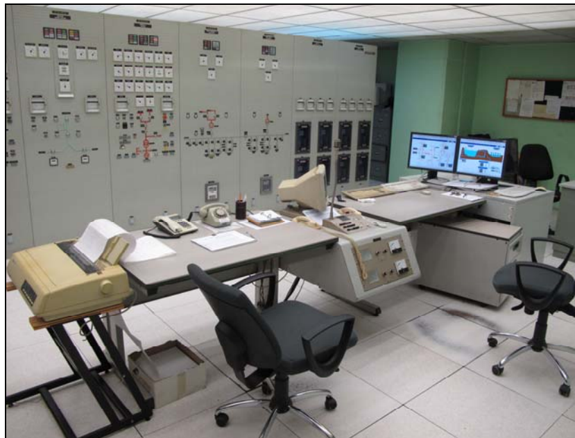
Εικόνα 16: Η αίθουσα ελέγχου του υπόγειου σταθμού παραγωγής
