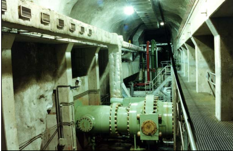
Εικόνα 19: Ο θάλαμος των κατάντη σφαιρικών βαλβίδων
