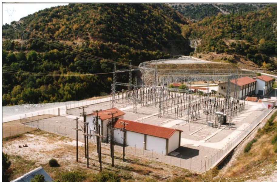
Εικόνα 22: Ο υποσταθμός 150/20 KV (Πηγή: Δ/ση ΥΗΣ Πηγών Αώου)
