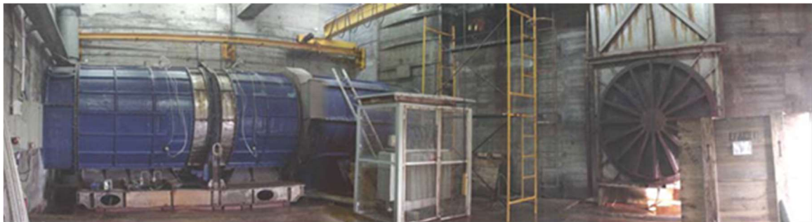
Εικόνα 2.20: Εγκατάσταση στο Pico στις Αζόρες (άνω) και ο αεροστρόβιλος της εγκατάστασης (κάτω) [41]
