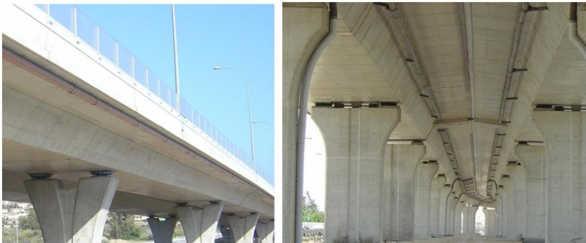
Εικόνα 4.15 Φωτογραφίες από το σύστημα σεισμικής μόνωσης σε γέφυρες στον Υπεραστικό Δρόμο Λεμεσού.
