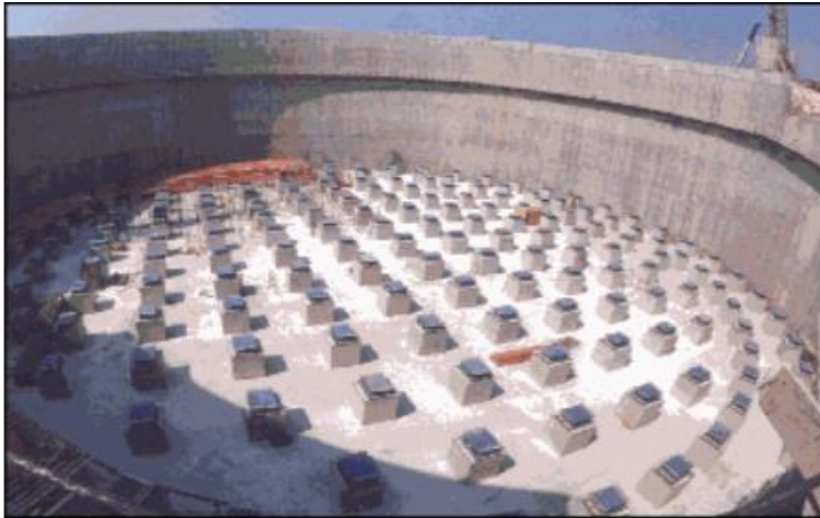
Εικόνα 4.9 Η στάθμη της σεισμικής μόνωσης στις δεξαμενές αποθήκευσης υγροποιημένου αερίου στη Ρεβυθούσα.
