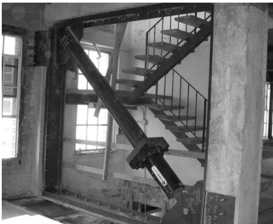
Εικόνα 3.8 Αποσβεστήρας ιξώδους απόσβεσης σε κτιριακό έργο.
