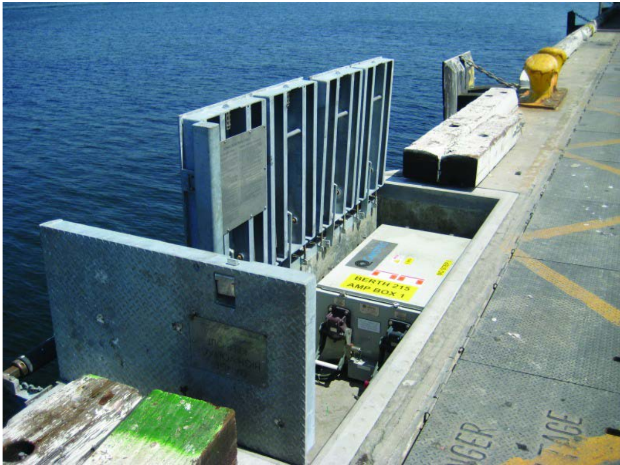
Σχήμα 2.9 Εγκατάσταση υποδοχής καλωδίων τροφοδοσίας
