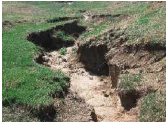
Εικόνα 3 Χαραδρωτική διάβρωση (Πηγή Μαρής ΔΟΥ Ι)
