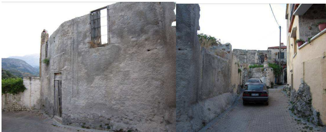
Εικόνα 53 Εγκαταλελειμμένα κτίρια της οδού Γ. Φραγκιαδάκη στην τοπική κοινότητα Σίβας.
