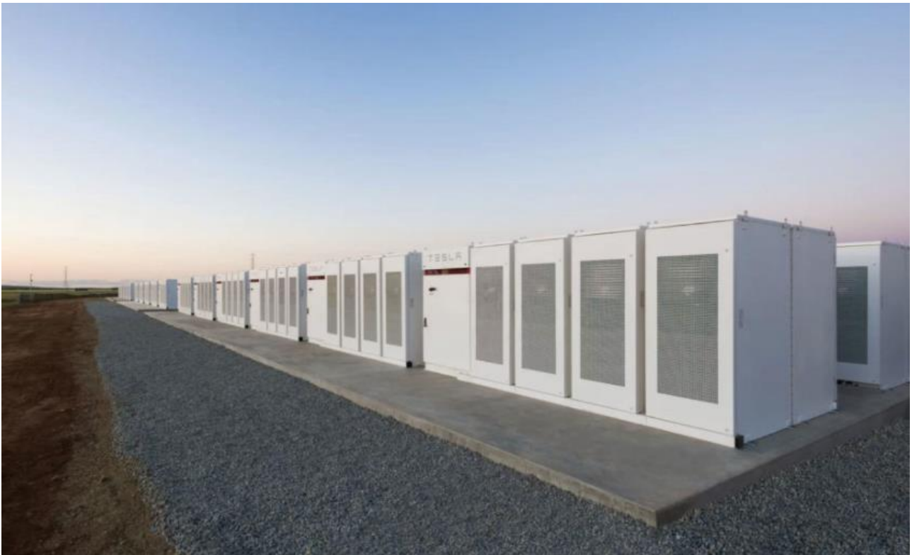
Εικόνα 20: Σταθμός Αποθήκευσης Ενέργειας 100MW με Tesla Powerpack στη Νότια Αυστραλία
