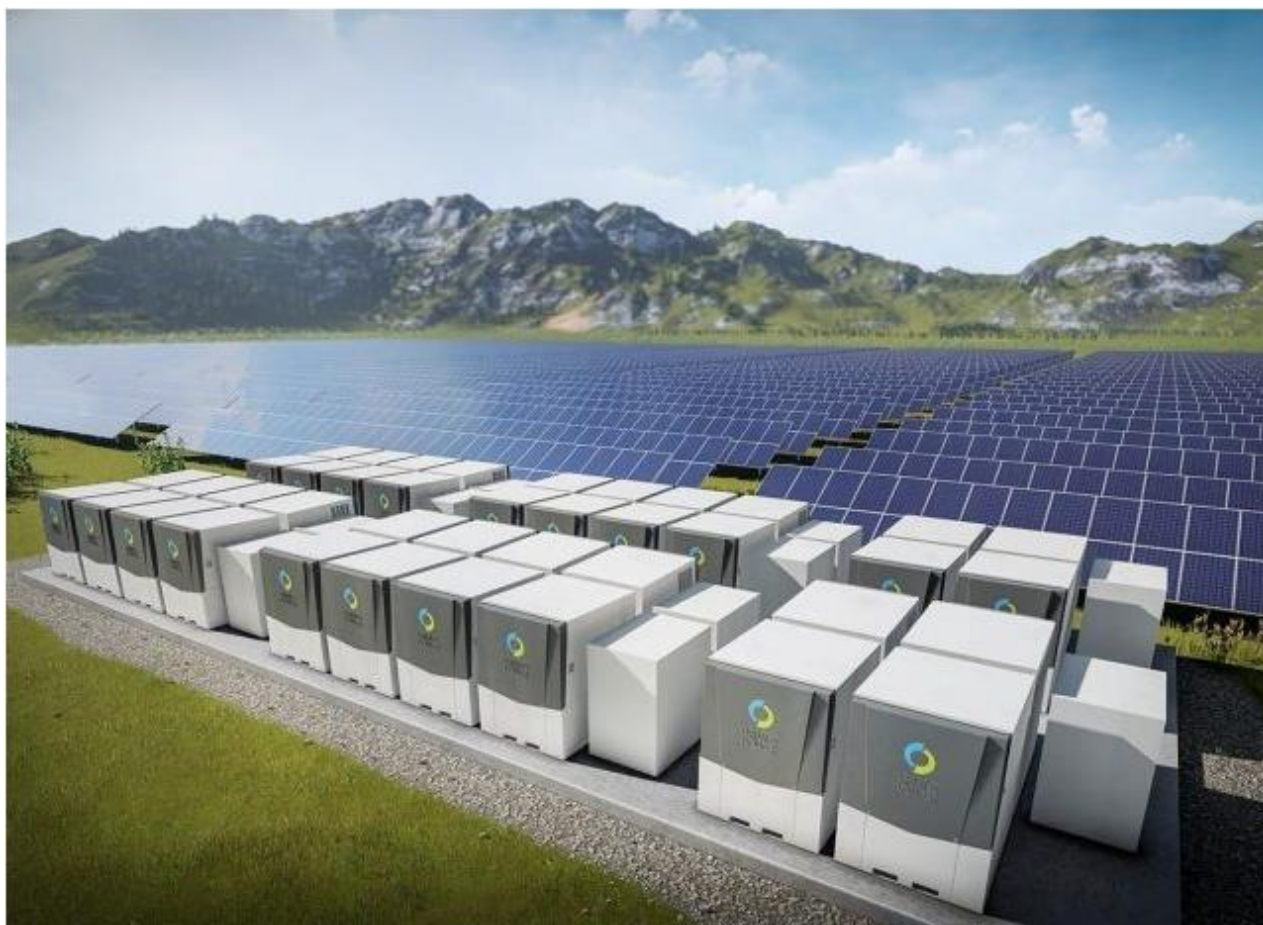
Εικόνα 21: Υβριδικό Πάρκο με Φωτοβολταϊκά και Μπαταρίες
