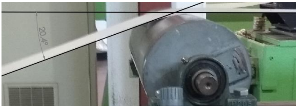
Εικόνα 4.2: Υφιστάμενο ράουλο αλλαγής διεύθυνσης κίνησης ταινίας μεταξύ ανέμης και φούρνου
