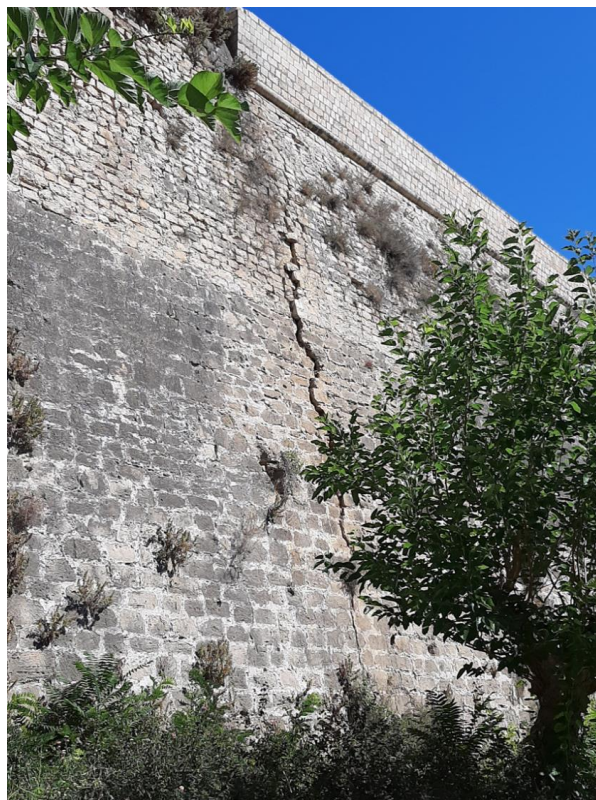
Εικόνα 20. Κατακόρυφη ρωγμή στο ευθύγραμμο τμήμα Μπέμπο-Αγ. Φραγκίσκου
