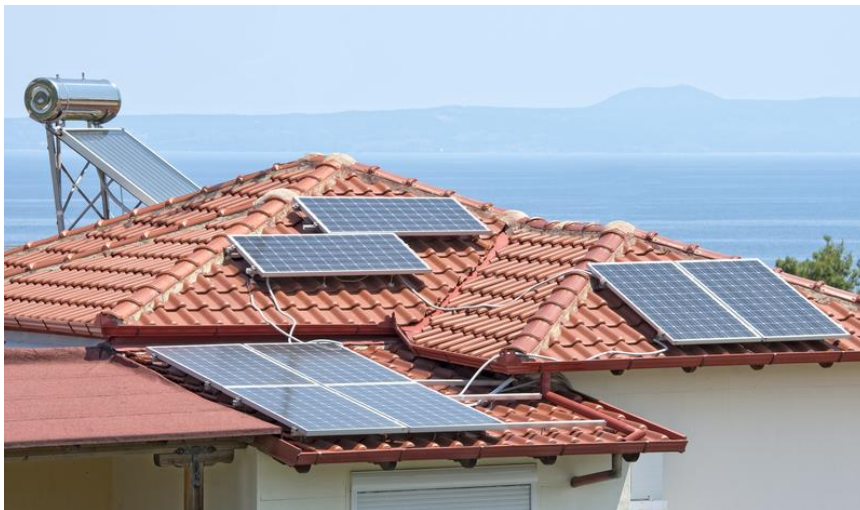
Εικόνα 1.3: Εγκατάσταση μεμονωμένων ηλιακών συστημάτων παραγωγής ζεστού νερού στην ταράτσα κατοικίας.
