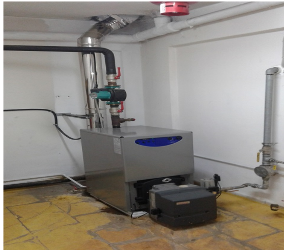
Σχήμα 4: Συμβατικός λέβητας φυσικού αερίου [10]
