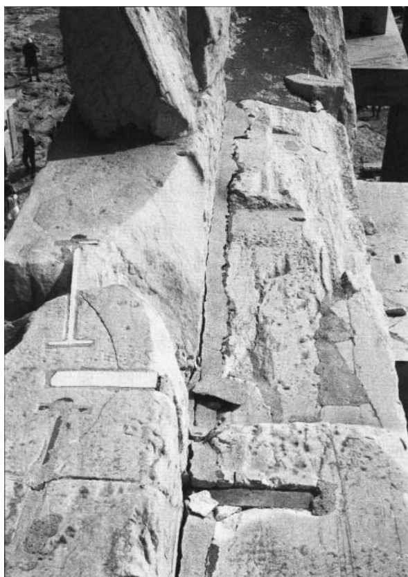
Εικόνα 120: Το 5ο μετακίονιο της βόρειας όψης. Τα τρία τεμάχια της εξωτερικής πλινθίδας συνδέονται με σιδηροδοκό ενσωματωμένη στην εσωτερική πλευρά. (Μελέτη Δομικής Αποκατάστασης της Βόρειας Όψης του Παρθενώνος, Κ.Ζάμπας, ΥΠΠΟ, ΕΣΜΑ, Αθήνα 2002, σ. 119)
