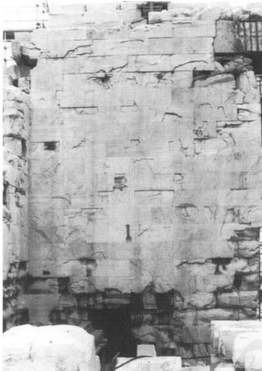
Εικόνα 55: Η εσωτερική όψη του νότιου τμήματος του δυτικού θυραίου τοίχου. Είναι εμφανής η εκτεταμένη θερμική θραύση των λιθοπλίνθων της. (Μελέτη Αποκαταστάσεως Οπισθονάου, Κ. Ζάμπας, ΥΠΠΟ, ΕΣΜΑ, Αθήνα 1994, σ.12)
