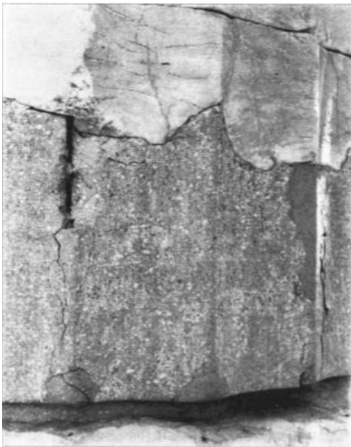
Εικόνα 104: Θραύση μαρμάρου από ράβδο οπλισμού του σκυροδέματος στον ΒΚ 8. (Μελέτη Δομικής Αποκαταστάσεως της Βόρειας Όψης του Παρθενώνος, Κ.Ζάμπας, ΥΠΠΟ, ΕΣΜΑ, Αθήνα 2002, σ. 49)
