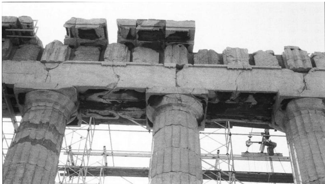
Εικόνα 111: Τμήμα της βόρειας όψης στο 10ο και 11ο μετακίονιο. Από το γείσο ΒΓ 37 του 10ου κατέπεσε τμήμα της προς Δ γωνίας. Στη συνέχεια το υπόλοιπο ετοιμόρροπο αποσπάστηκε. (Μελέτη Δομικής Αποκαταστάσεως της Βόρειας Όψης του Παρθενώνας, Κ.Ζάμπας, ΥΠΠΟ, ΕΣΜΑ, Αθήνα 2002, σ. 111)
