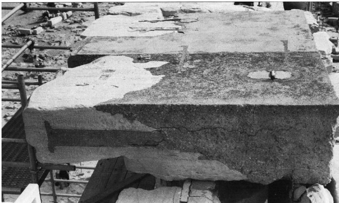
Εικόνα 113: Τα γείσα ΒΓ 31 έως 29 με μεγάλα συμπληρώματα από σκυρόδεμα στα ουραία τμήματα. Έχουν σοβαρές βλάβες από τις σιδηροδοκούς και τους οπλισμούς του σκυροδέματος. (Μελέτη Δομικής Αποκατάστασης της Βόρειας Όψης του Παρθενώνος, Κ.Ζάμπας, ΥΠΠΟ, ΕΣΜΑ, Αθήνα 2002, σ. 113)
