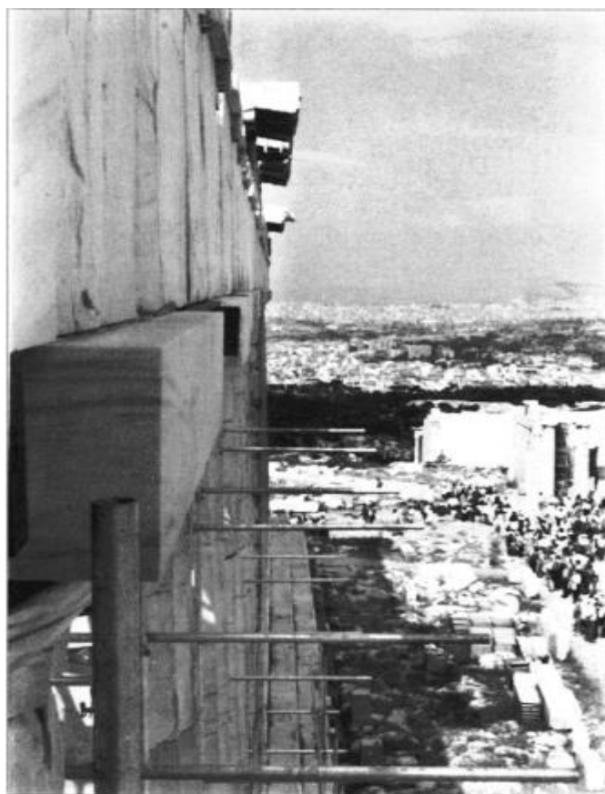
Εικόνα 121: Βλάβες στον θριγκό της βόρειας πλευράς από οξειδωμένα σθδηρά στοιχεία (Μελέτη Δομικής Αποκατάστασης της Βόρειας Όψης του Παρθενώνος, Κ.Ζάμπας, ΥΠΠΟ, ΕΣΜΑ, Αθήνα 2002, σ. 49)
