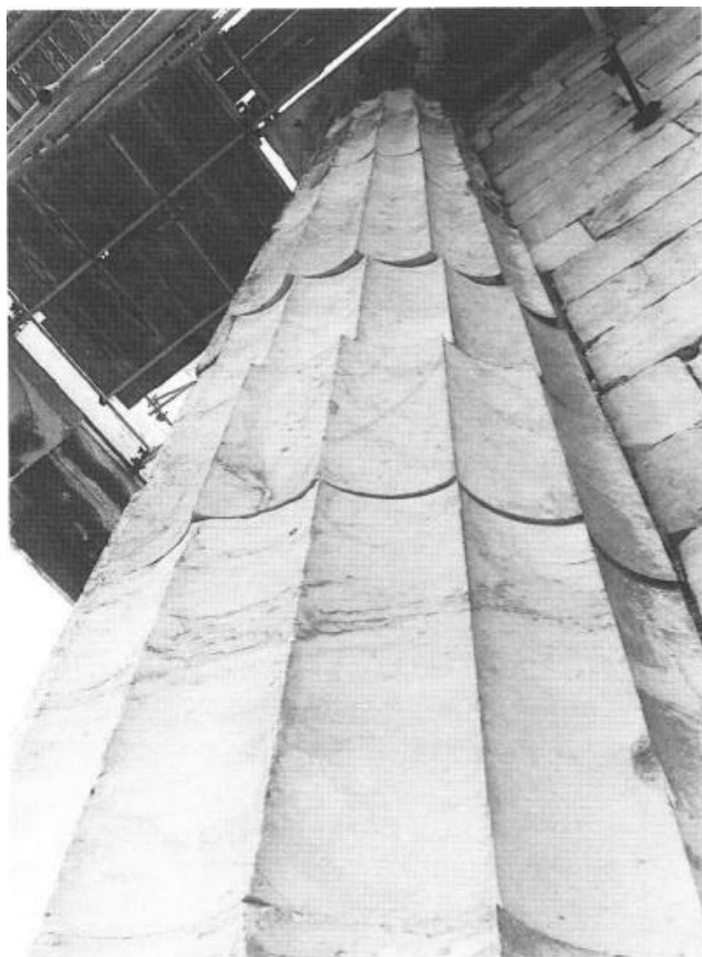
Εικόνα 66: Ο ΝΔ κίονας του Οπισθονάου με εμφανείς τις μετακινήσεις των σπονδύλων του (Μελέτη Αποκατάστασης του Παρθενώνος, Τόμος 3β, Δομική Μελέτη Αποκατάστασης Οπισθονάου, Κ. Ζάμπας, ΥΠΠΟ, ΕΣΜΑ, Αθήνα 1994, σ. 15)
