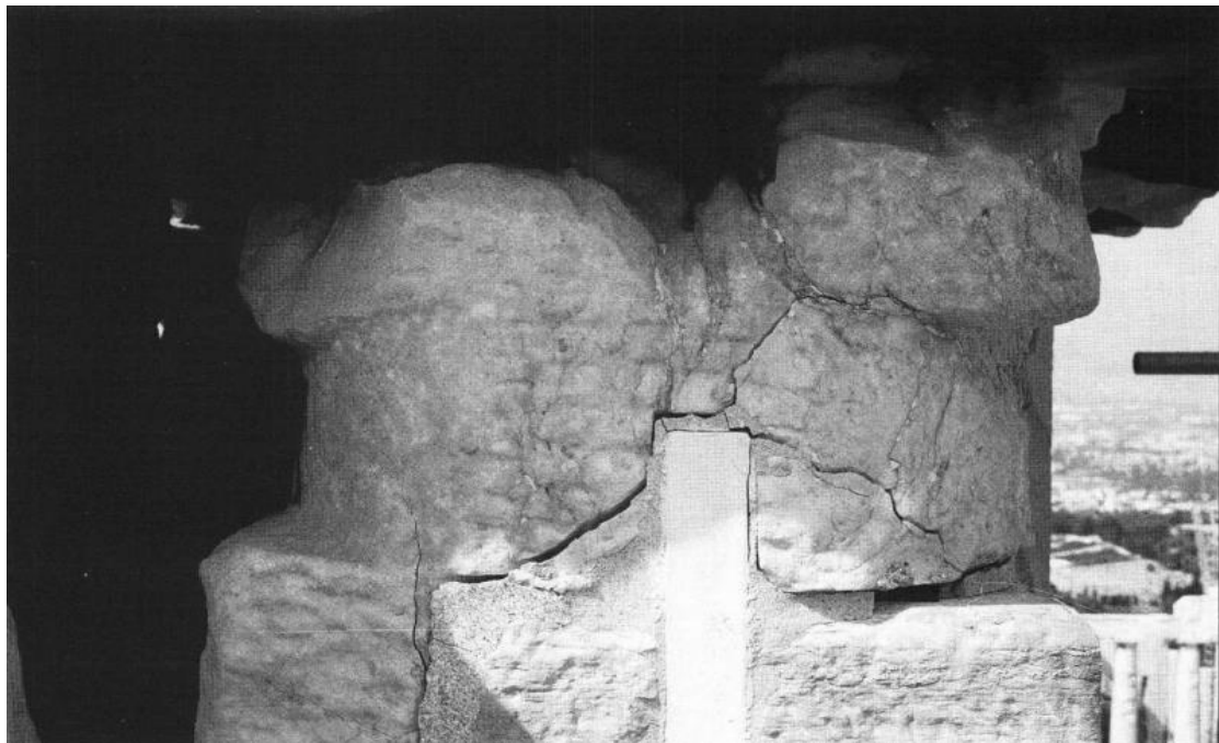
Εικόνα 115: Ο λίθος πλήρωσης πάνω στον οποίο εδράζεται το ΒΓ 29 έχει κατακερματιστεί λόγω της διόγκωσης των εσωτερικών αθέατων σιδηρών συνδέσμων, παρότι ο πλευρικός σύνδεσμος αντικαταστάθηκε με ορειχάλκινο το 1974. (Μελέτη Δομικής Αποκαταστάσεως της Βόρειας Όψης του Παρθενώνος, Κ.Ζάμπας, ΥΠΠΟ, ΕΣΜΑ, Αθήνα 2002, σ. 114)
