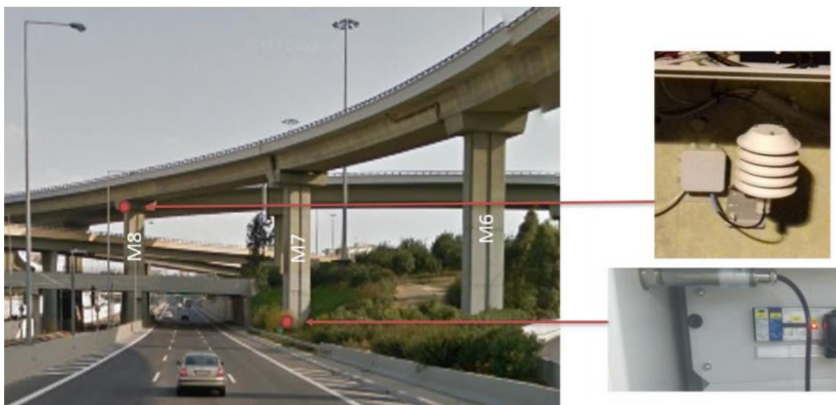
Σχήμα 3-10: Θέσεις τοποθέτησης αισθητήρων καταγραφής μετεωρολογικών Figure 3-10: Installation points of the meteorological sensors
