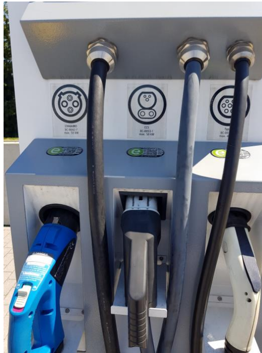
Εικόνα 2.9. – Σταθμός ηλεκτρικής φόρτισης χρηματοδοτούμενος από το ταμείο «Συνδέοντας την Ευρώπη» ο οποίος συνδυάζει 3 διαφορετικά πρότυπα φόρτισης (CHAdeMO, CCS, Type 2).
