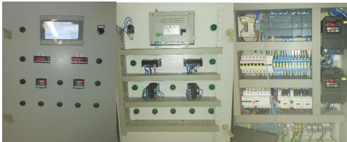
Σχήμα 12: Κεντρικός πίνακας ελέγχου PLC
