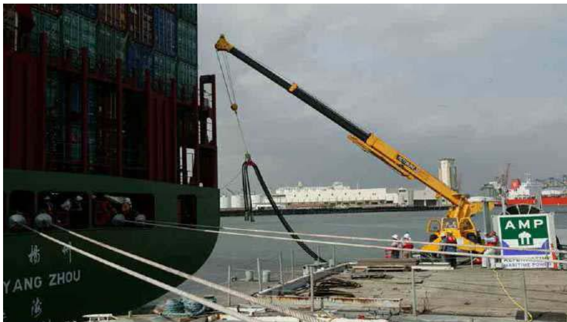
Σχήμα 6.10: Πλοίο κατά τη διάρκεια τροφοδότησης των ενεργειακών του αναγκών από την ξηρά
