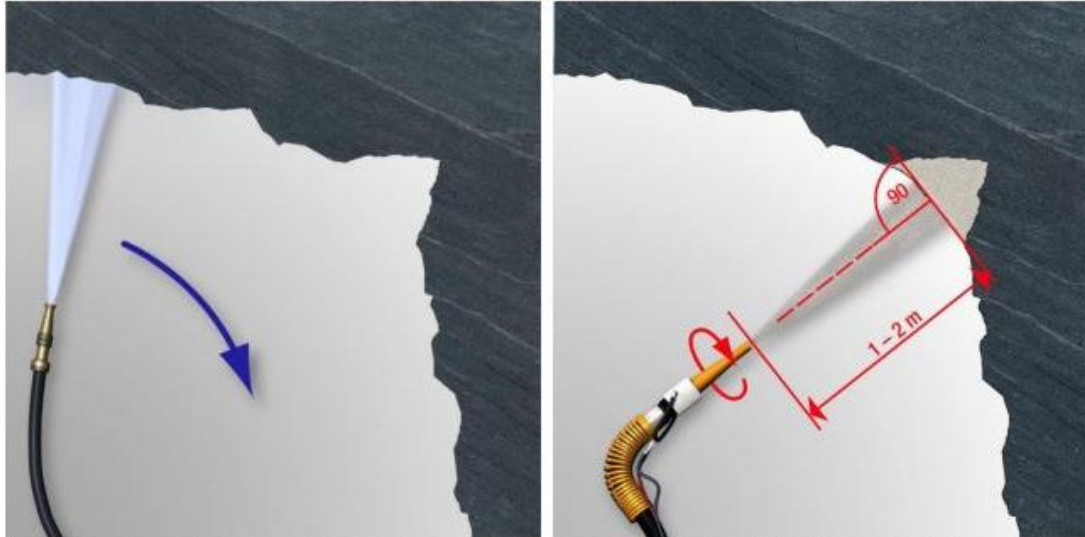
Σχήμα 3. 13: Προκαταρκτική φάση εφαρμογή εκτοξευόμενου σκυροδέματος. Αριστερά πραγματοποιείται ο καθαρισμός της επιφάνειας εφαρμογής από την σκόνη με χρήση νερού, ενώ δεξιά διακρίνεται η σωστή απόσταση ακροφύσιου και επιφάνειας εφαρμογής (SIKA HELLAS ABEE) .
