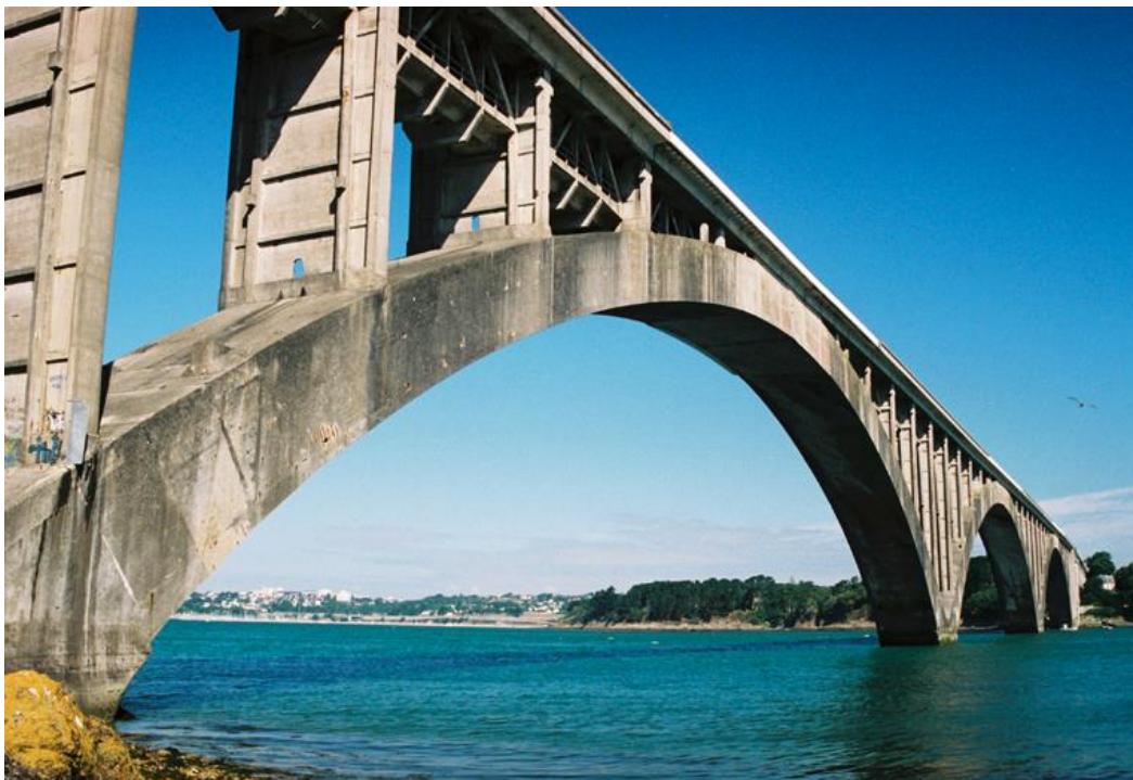
Σχήμα 8. Γέφυρα Plougastel (1930) από οπλισμένο σκυρόδεμα, η μελέτη της οποίας εκπονήθηκε από το διάσημο Γάλλο γεφυροποιό E. Freyssinet
