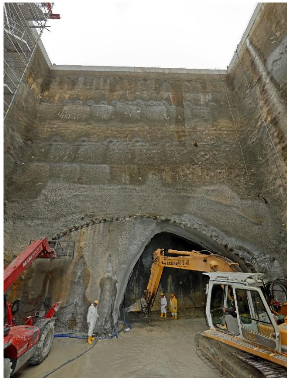
Εικόνα 2-4: Έναρξη εκσκαφής σήραγγας για τη σύνδεση του φρέαρ Δεληγιάνη με τη σήραγγα του TBM (Πηγή: AVAX)
