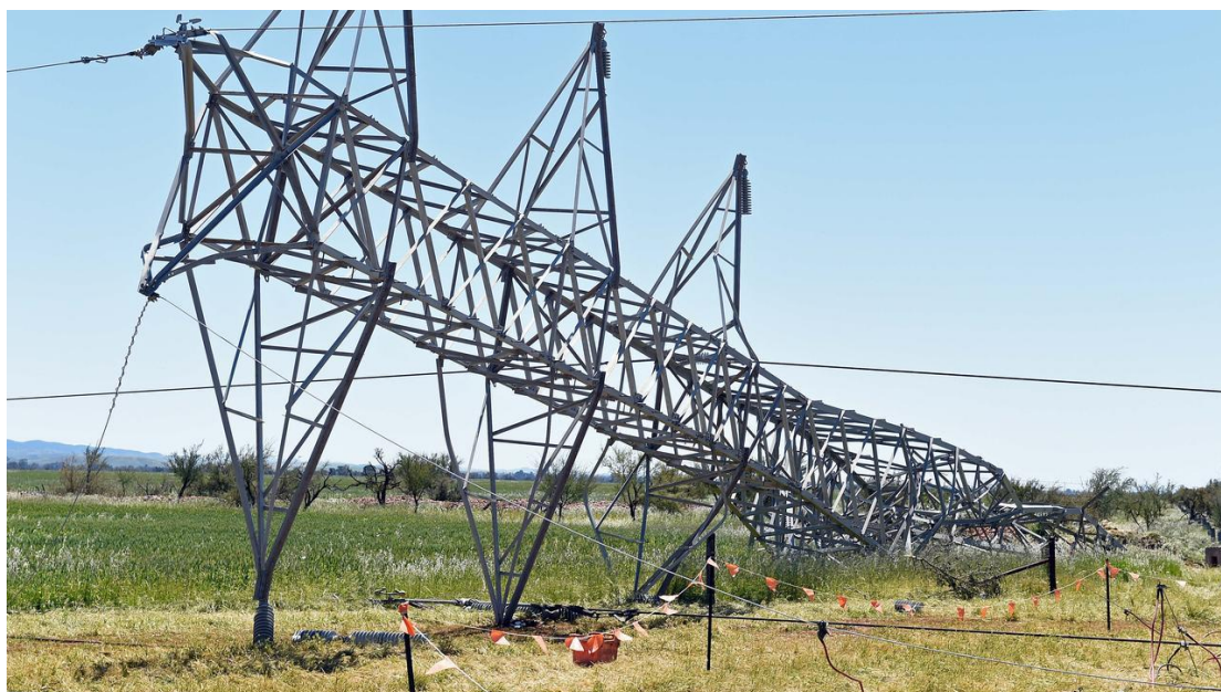
Εικόνα 4. Κατεστραμμένος πυλώνας μεταφοράς στην Αυστραλία. Σεπτέμβριος 2016
