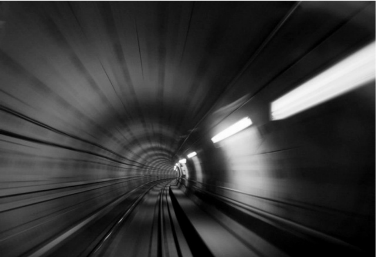
Η σήραγγα ως αγωγός γέννησης του νέου ταχύτερου χρόνου της πόλης – Μάνια Μπενίση© / Φωτογραφικό αρχείο Αττικό Μετρό Α.Ε.
