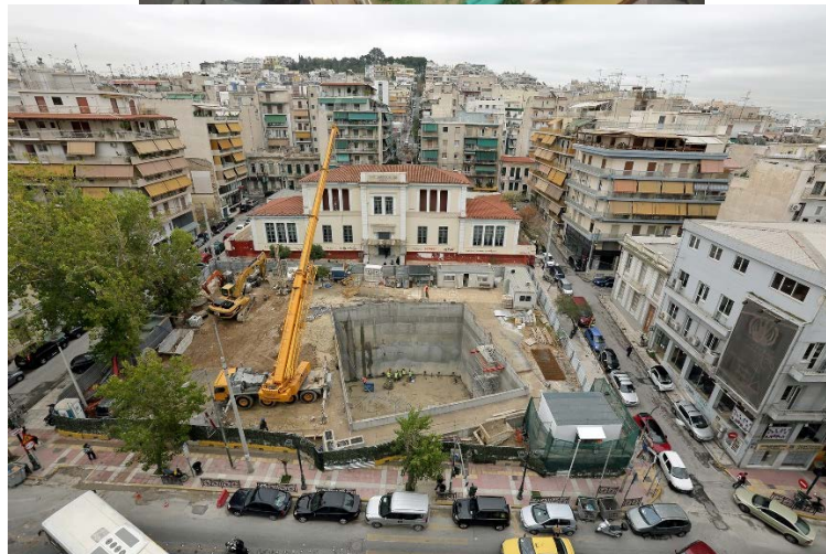
Παρουσίαση των μαθητών της ΣΤ δημοτικού του 21 ου δημοτικού σχολείου Πειραιά για την επίδραση του εργοταξίου στη σχολική τους ζωή και τις προτάσεις τους για ανάπλαση της γειτονιάς του σχολείου κατά την ολοκλήρωση του έργου – φωτογραφία: (α) Μ. Μπενίση© (β) Σ. Σπυρίδωνος ©./ Φωτογραφικό Αρχείο Αττικό Μετρό Α.Ε.
