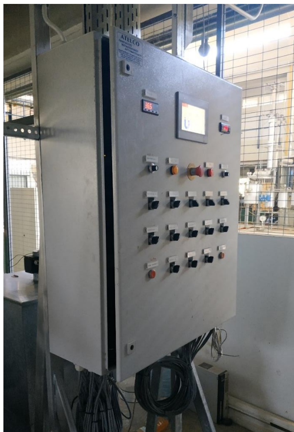
Εικόνα 6. 1 Ηλεκτρονικός Πίνακας Ελέγχου (PLC)
