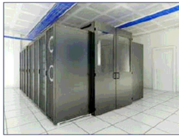
Εικόνα 28. Εξωτερική όψη του κλειστού ψυχρού διαδρόμου
