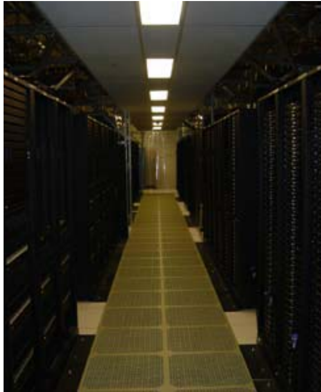
Εικόνα 44. Φωτογραφία ψυχρού διαδρόμου σε ένα κέντρο δεδομένων υψηλής θερμικής πυκνότητας
