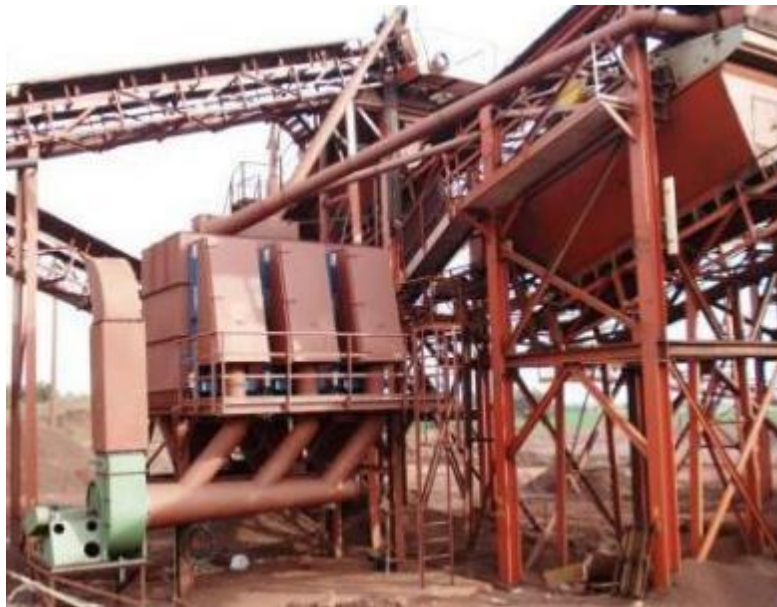
Σχήμα 3.10. Σύστημα αποκονίωσης εργοστασίου Λάρυμνας
