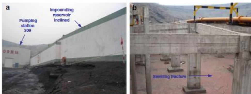
Εικόνα 69: α.Εικόνα του αντλητικού σταθμού 309 στον τομέα E1200 β.Εικόνα της ρωγμής διόγκωσης στη δεξαμενή #2 (Nie L. κ.α. 2014)
