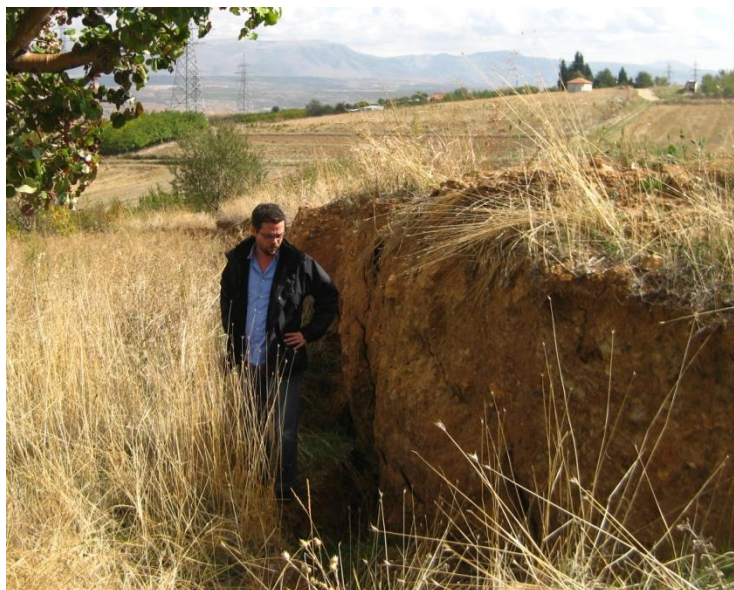
Εικόνα 10 Εδαφική υποχώρηση (~2m) από τη νοτιοανατολική στέψη του πρανούς της εκσκαφής στη Μαυροπηγή (2013) (Zevgolis et al. 2019)
