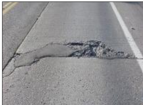
Εικόνα 2.32 Παράδειγμα αποφλοίωσης σκυροδέματος σε δύσκαμπτο οδόστρωμα
