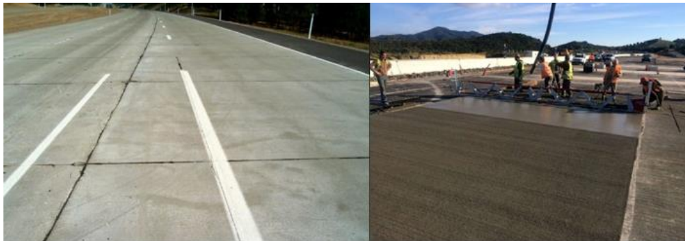
Εικόνα 2.4 Δύσκαμπα οδοστρώματα σε αυτοκινητόδρομο
