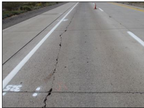
Εικόνα 2.31 Οριζόντια ρηγμάτωση σε δύσκαμπτο οδόστρωμα
