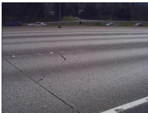
Εικόνα 2.29 Ρηγμάτωση άκρου σε δύσκαμπτο οδόστρωμα
