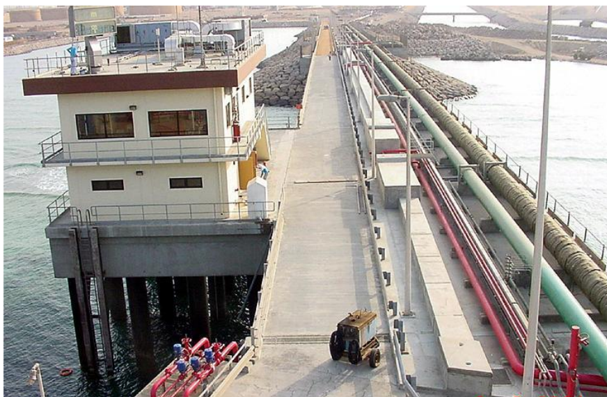
Εικόνα 23: Σταθμός φορτοεκφόρτωσης καυσίμων- Shoaiba Power Plant
