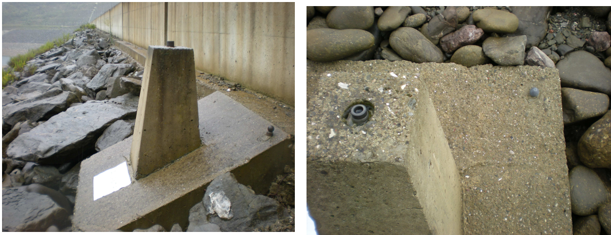
Σχήμα 7.5 : Σημείο ελέγχου στη στέψη (ανάντη) του φράγματος όπου φαίνεται στην πάνω δεξιά γωνία το σημείο, όπου γίνεται ο έλεγχος του υψομέτρου και της καθίζησης - Control point on the crest (upstream) of the dam, showing on the top right corner the point, which made the control of elevation and settlement.
