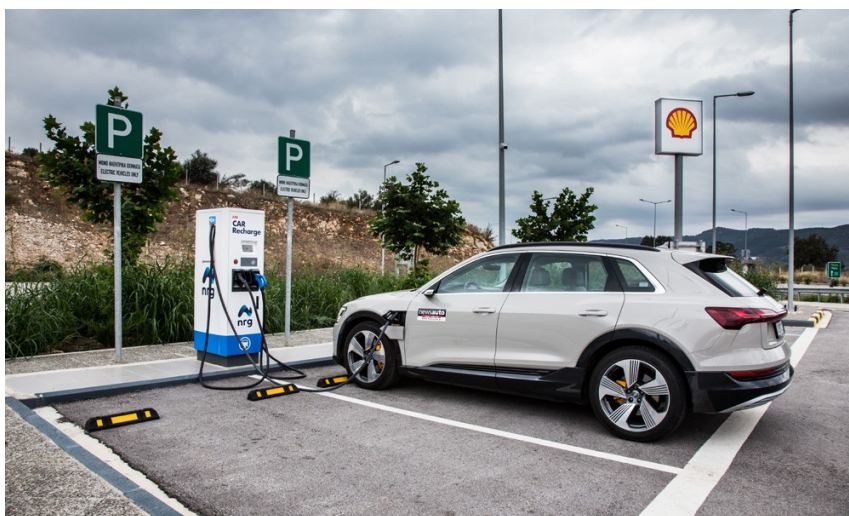
Εικόνα 14. Φόρτιση με ταχυφορτιστή στον αυτοκινητόδρομο ( www.4troxoi.gr )
