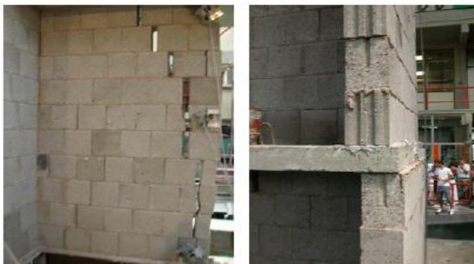
Εικόνες 2.15 a,b Ρωγμές κατά το ύψος του πρώτου οριζοντίου τοίχου,
