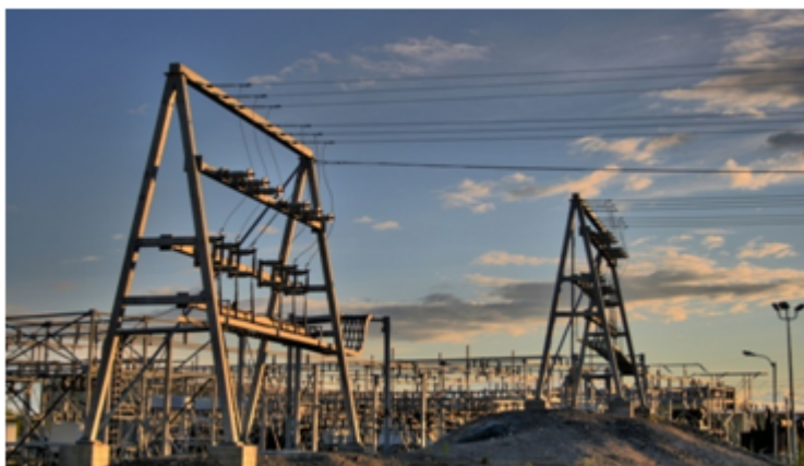
ΕΙΚΟΝΑ 7: Απεικονίζεται Υποσταθμός του Δικτύου Διανομής Ενέργειας
