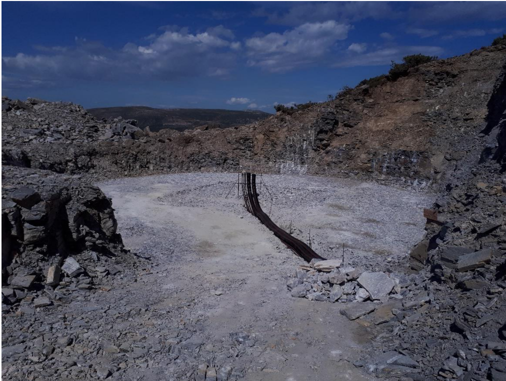
Σχήμα 5.19: Σωληνώσεις Καλωδίων Α/Γ από Επιτόπια Επίσκεψη σε υπό Κατασκευή Αιολικό Πάρκο
