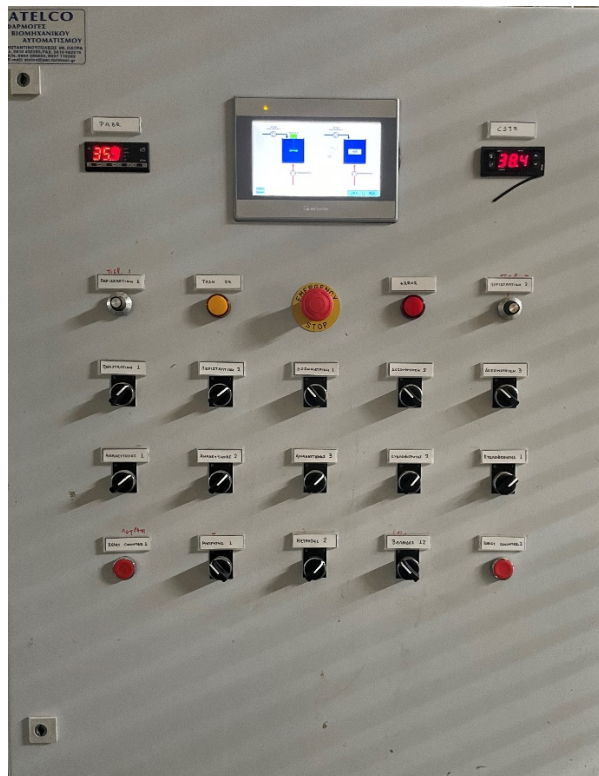
Εικόνα 18: Πίνακας Ελέγχου PLC
