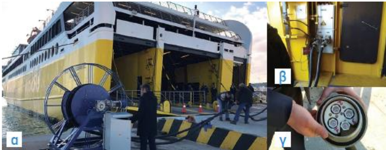
Εικόνα 3-9: Φωτογραφίες από την εφαρμογή στο λιμάνι της Κυλλήνης: α) Το σύστημα διαχείρισης του ηλεκτρικού καλωδίου διασύνδεσης με τον πίνακα στη θέση ηλεκτροδότησης. β) Ο πίνακας διασύνδεσης με την ξηρά, πάνω στο κατάστρωμα του πλοίου. γ) Λεπτομέρεια του ραμματολήπτη της ηλεκτρικής διασύνδεσης [21].
