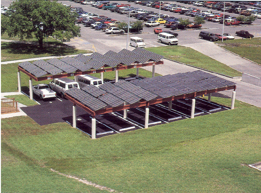
Εικόνα 50: Υπόστεγο στάθμευσης αυτοκινήτων EV με 20 kW από πλέγμα Φ/Β για τη φόρτιση EV που βρίσκεται στο Πανεπιστήμιο της Νότιας Florida (1991)
