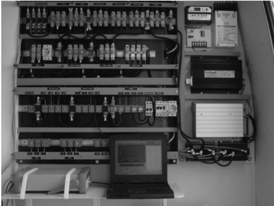
Εικόνα 6: Πίνακας σύνδεσης εγκατεστημένος μέσα στο πρωτότυπο
