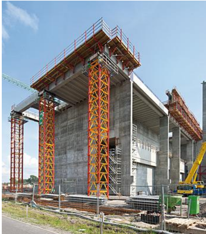
Σχήμα 1.4 : Ικρίωματα υποστήλωσης σε σταθμό παραγωγής ενέργειας στη Γερμανία
