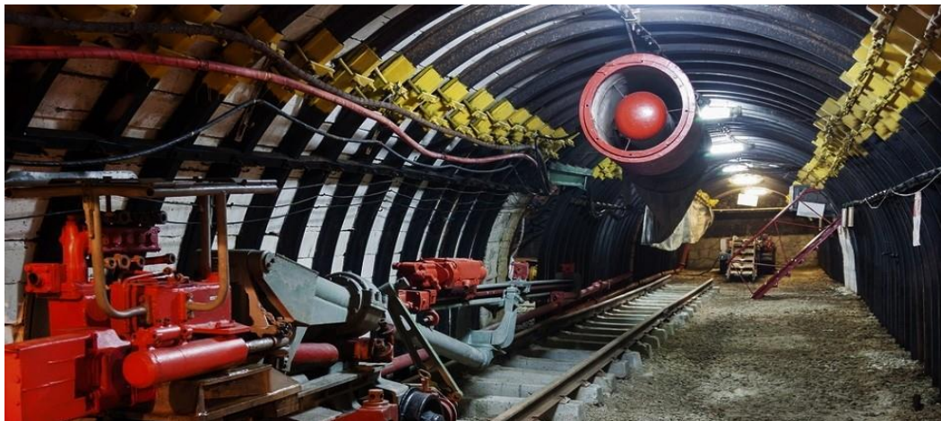
Εικόνα 2.16 : Άποψη ανεμιστήρα βοηθητικού αερισμού
