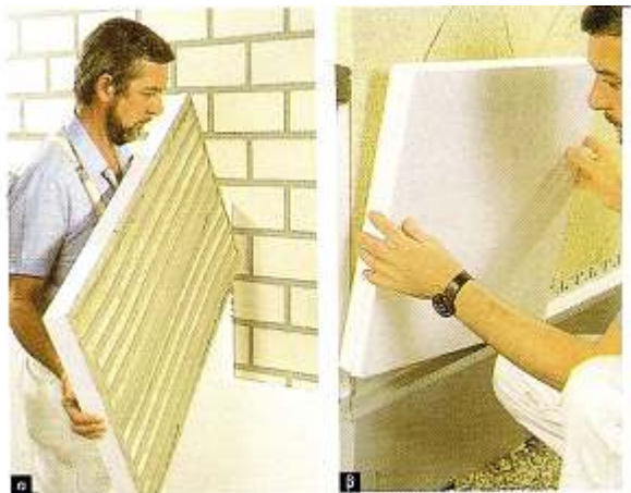
Εικόνα 4.2: τοποθέτηση πλακών διογκωμένης πολυστερίνης α) με κόλληση και β) με μηχανική στερέωση (ΤΕΧΝΙΚΟ ΠΕΡΙΟΔΙΚΟ ΚΤΙΡΙΟ Θερμομόνωση και Στεγανοποίηση των Κτιρίων)
