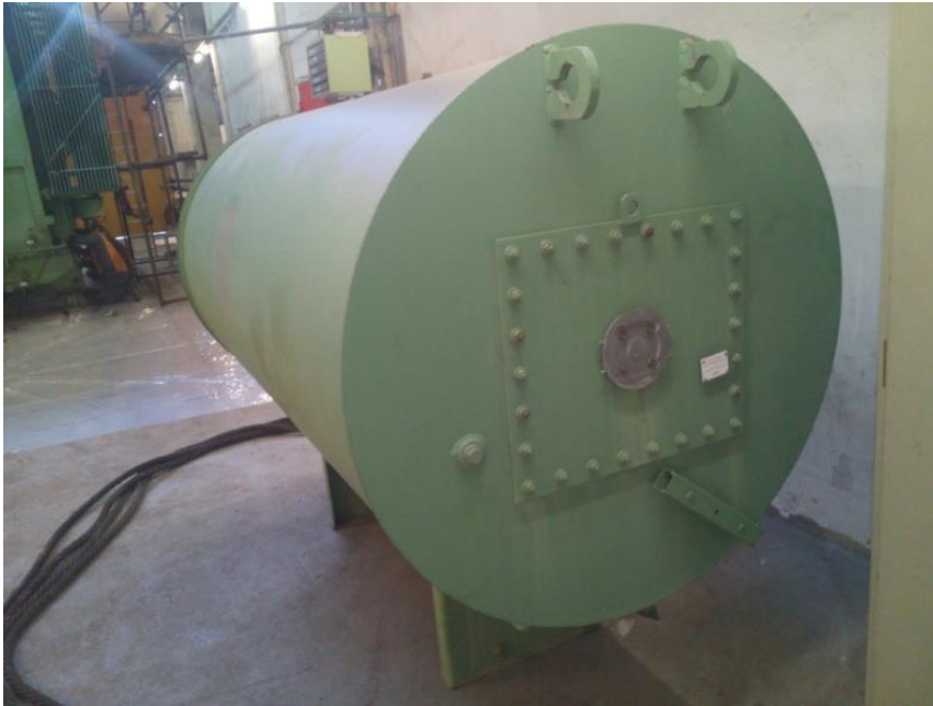
Εικόνα 2.21: Δοχείο διαστολής (oil conservator). Διακρίνεται η διαμερισματοποίηση για να επιτευχθεί ο διαχωρισμός του δοχείου διαστολής του ΣΑΤΥΦ (μικρό-εσωτερικό, τετράγωνο διαμέρισμα) από αυτό του Μ/Σ ισχύος (μεγάλο-εξωτερικό, κυλινδρικό διαμέρισμα).
