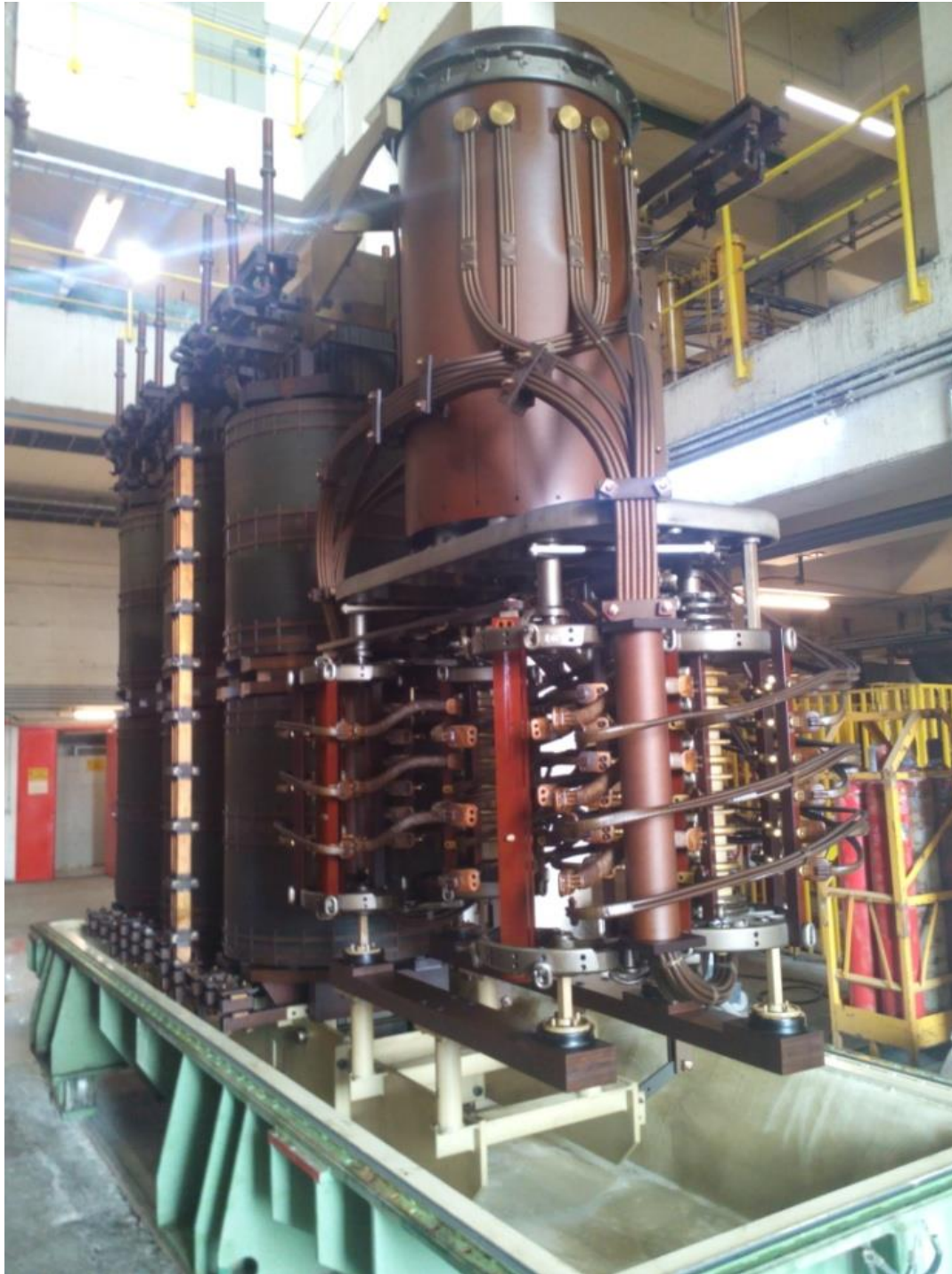
Εικόνα 2.15: Επιλογέας (tap-selector), κατά τη διάρκεια εργασιών επισκευής του, συνδεδεμένος τόσο με τις απολήξεις του ρυθμιστικού τυλίγματος όσο και με το μεταγωγικό διακόπτη (diverter switch).
