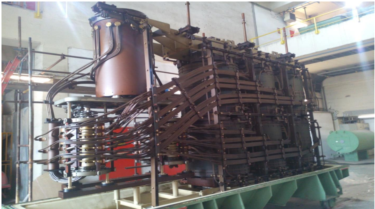
Εικόνα 2.5: ΣΑΤΥΦ ενσωματωμένο σε Μ/Σ ισχύος Υ/Σ μεταφοράς (ΥΤ / ΜΤ).
