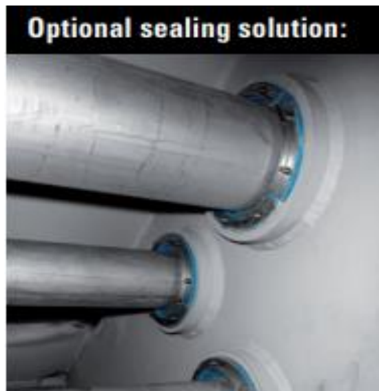
Εικόνα 18: Αγωγοί για τα καλώδια τροφοδοσίας ( www.roxtec.com/en/industries/marine/ )
