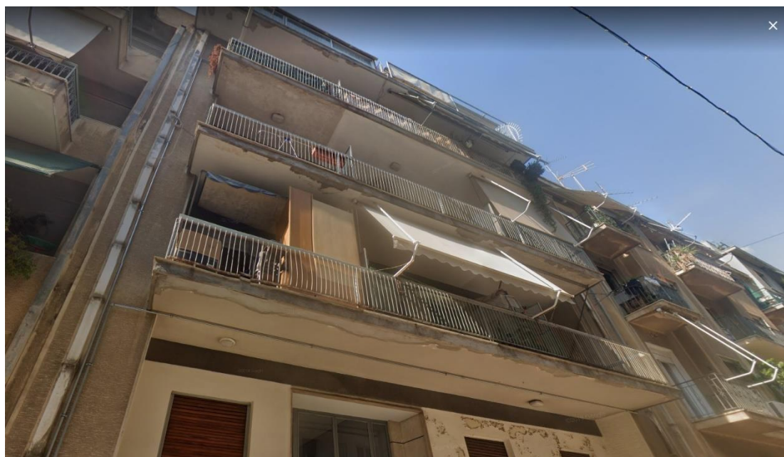
Σχήμα 21 - Υπάρχουν εμφανείς φθορές στην πρόσοψη κτηρίου (S6=0), Πηγή: Google Street View, 2019.
