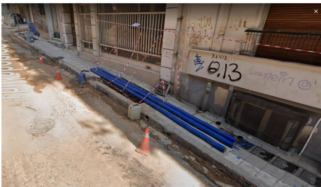
Σχήμα 73 - Έργα πεζοδρομίου εμποδίζουν τη διέλευση ( E5=0 ), Πηγή: Google Street View, 2019.
