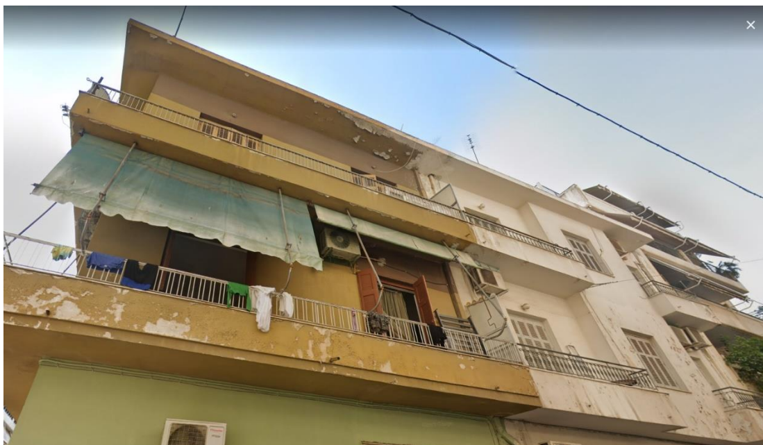
Σχήμα 22 - Υπάρχουν εμφανείς φθορές στην πρόσοψη κτηρίου ( S6=0 ), Πηγή: Google Street View, 2019.
