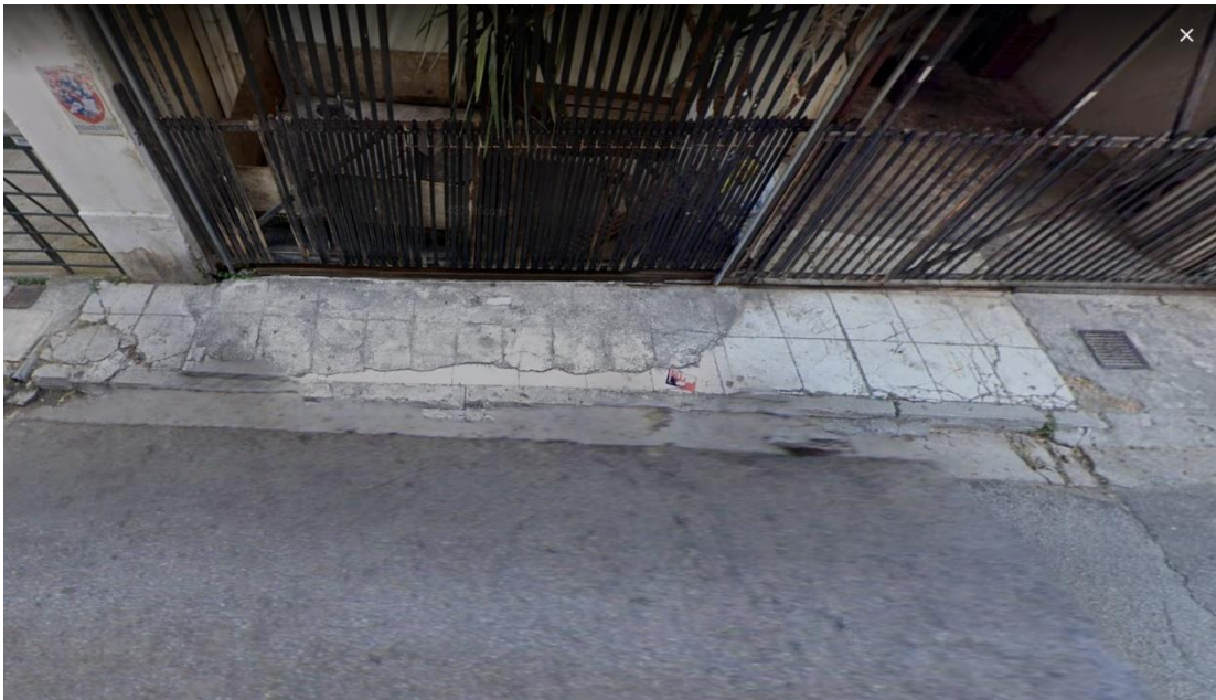
Σχήμα 31 - Το πεζοδρόμιο έχει εμφανείς φθορές (S10=0), Πηγή: Google Street View, 2019.
