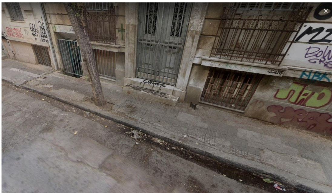
Σχήμα 32 - Το πεζοδρόμιο έχει εμφανείς φθορές ( S_{10}=0 ), Πηγή: Google Street View, 2019.
