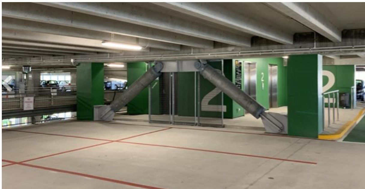
Σχήμα 1.8: Συνδέσμοι δυσκαμψίας BRB στο Wellington Carpark της Νέας Ζηλανδίας[23]
