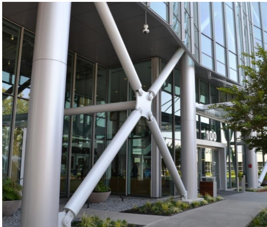
Σχήμα 1.7: Σύνδεσμοι δυσκαμψίας BRB στο Menlo Getaway αρθρωτής σύνδεσης[23]
