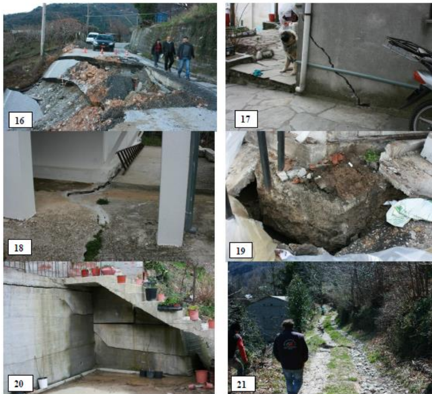
Εικόνα 3.10: Φωτογραφίες κατολισθήσεων στην περιοχή με αντιστοιχία αριθμών του πίνακα 3.6 (ΙΓΜΕ, 2018)
